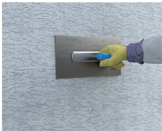
Abb. 2.3: Einlagiger Leichtputz als Außenputz auf Porenbetonmauerwerk – Aufbringen der zweiten Schicht und Strukturieren der Oberfläche
